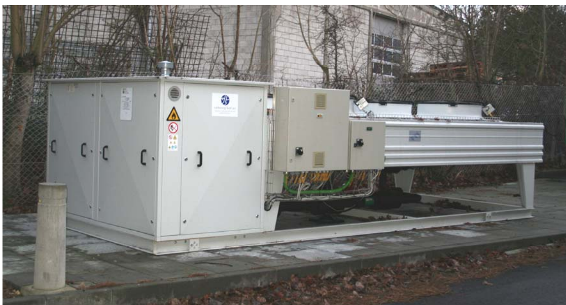
Vandkøleanlægget med maskinhus og luftkølet kondensator
