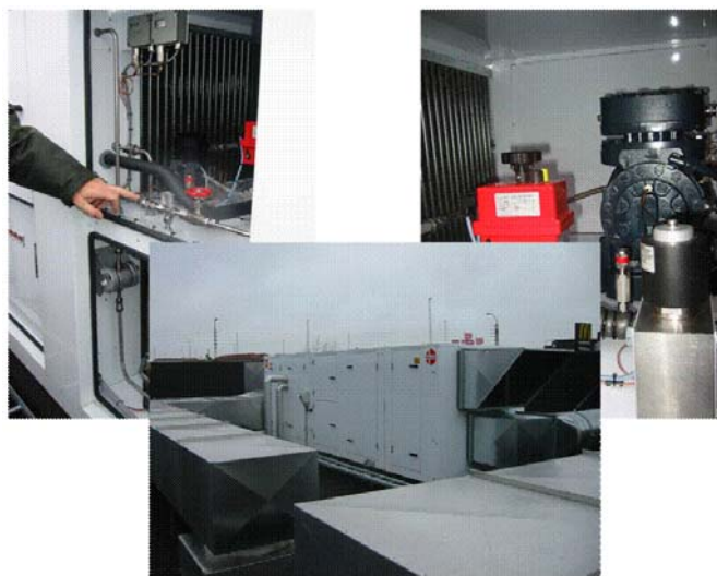
Detaljer fra HVAC-unitten
