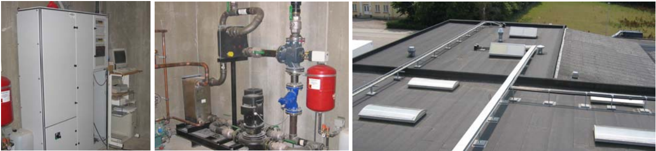
Elpanelet, kondensatoren med cirkulationspumperne fra Grundfos, samt en lille del af rørføringen på taget
