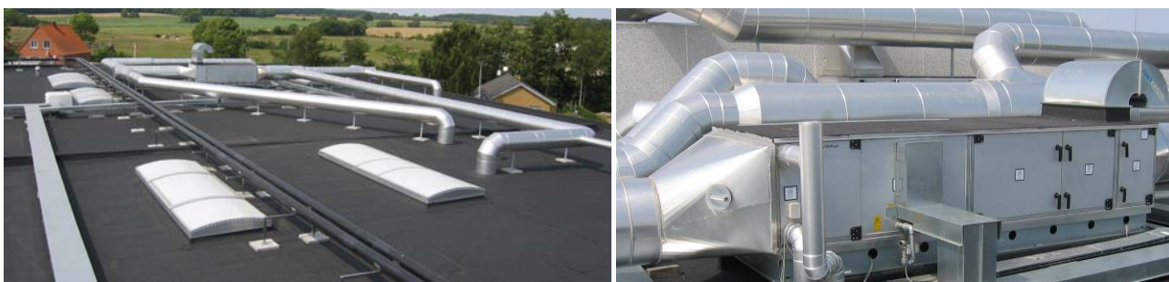
Luftkanaler og ventilations-unit fra ECO på taget
