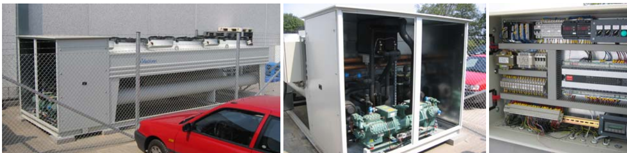
Samlet pumpe- og køleunit for CO 2 og R404A fra Birton med detaljer af maskinhus og elpanel
