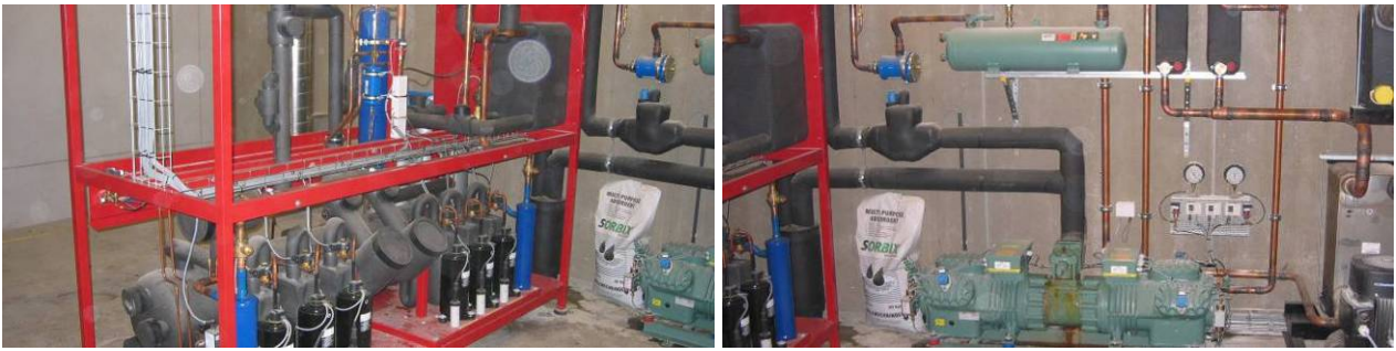
Kompressorunit for CO 2 fra Tempcold og kompressorer for R404A fra Bitzer
