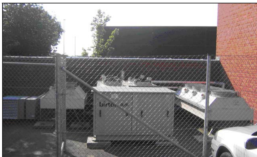
Vandkøleanlægget på dets placering udendørs
